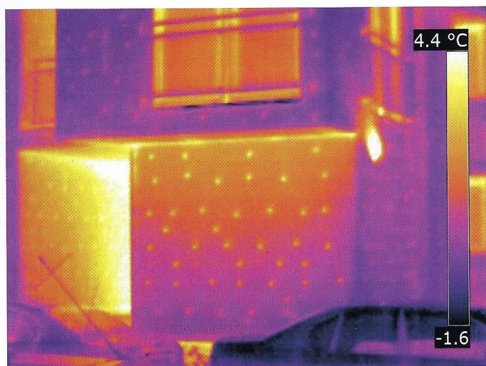
Termogram nr 3 Punktowe mostki cieplne – nieodpowiednie mocowanie izolacji termicznej.
