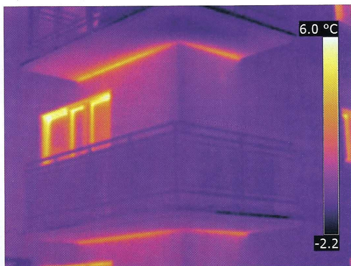
Termogram nr 1 i 2. Liniowe mostki cieplne nieocieplonej płyty balkonowej z zewnątrz i wewnątrz.
