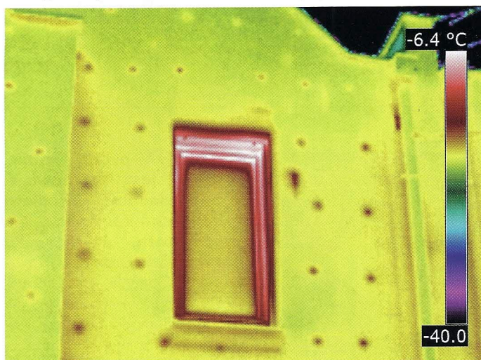
Termogram nr 4 Punktowe mostki cieplne – nieodpowiednie mocowanie izolacji termicznej.
