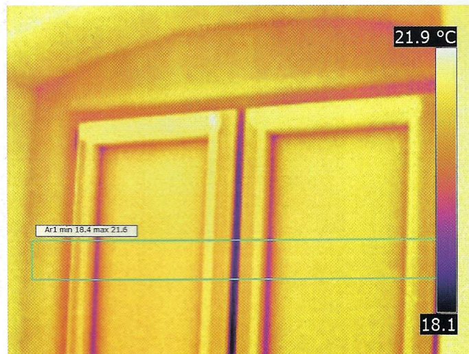
Termogram nr 8. Poprawne okno oraz montaż. Niewielki jednak mostek cieplny na słupku środkowym.
